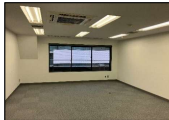
※換気設備無し
